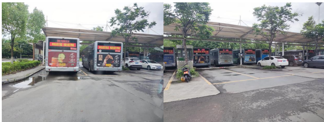
图 2- 11 赤壁市公交集团（高铁站）充电站
