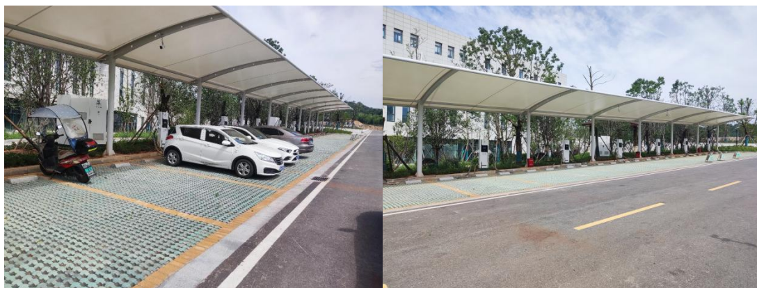
图 2- 8 咸安区文体中心充电站
